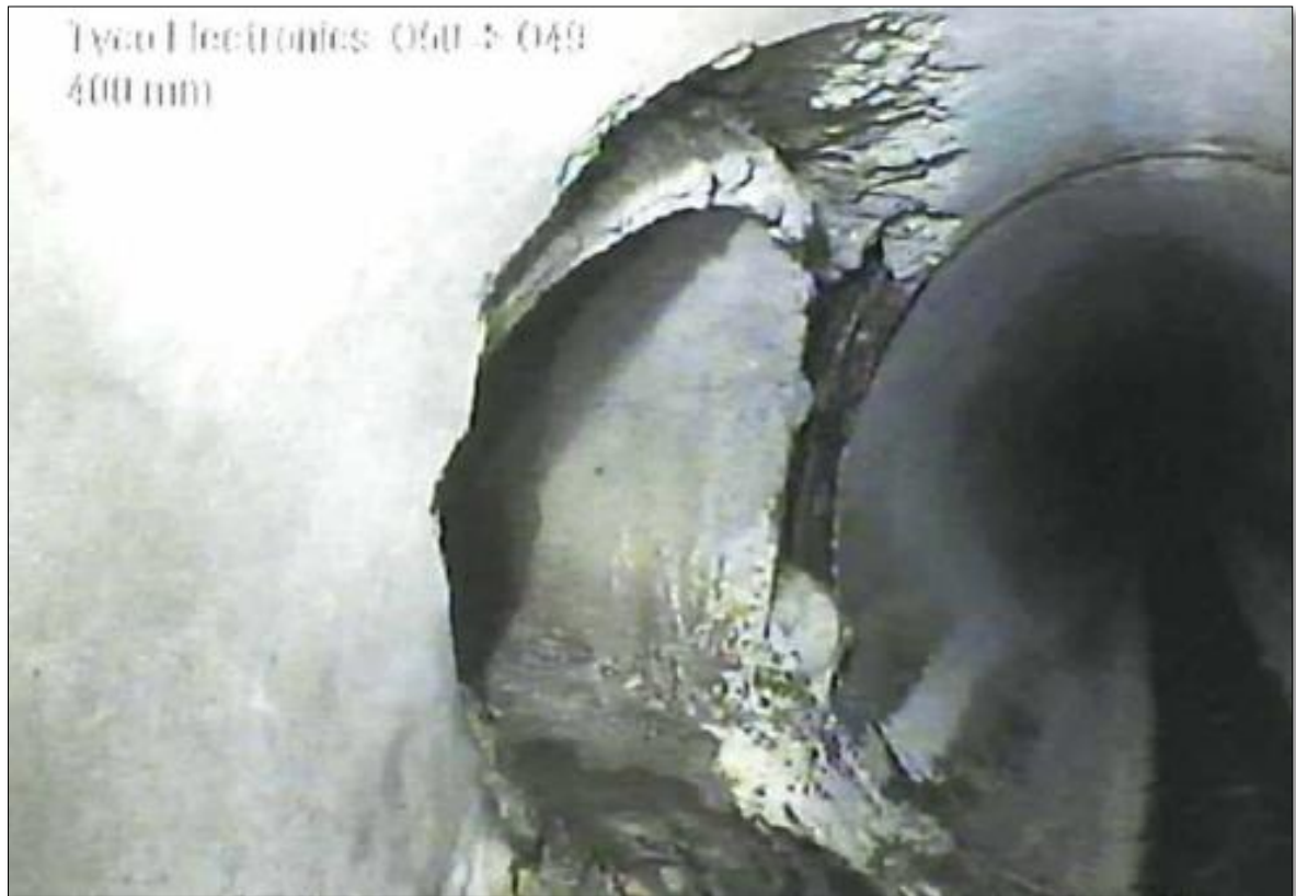
Abb. 7 Einlauf nicht verputzt (schadhaft, undicht)
