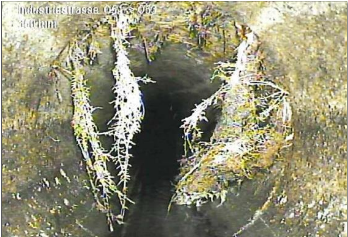
Abb. 11 Wurzeleinwuchs, stark, Gesamtumfang bei Muffe
