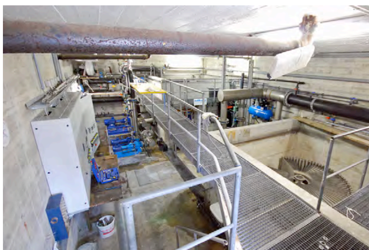
Abb. 4: Badewasseraufbereitung mit dem neuen Schalttableau sowie den alten technischen Einrichtungen wie Pumpen- und Filteranlagen
