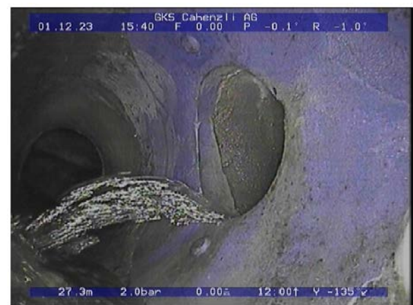
Schadhafter Anschluss nach der Robotersanierung
