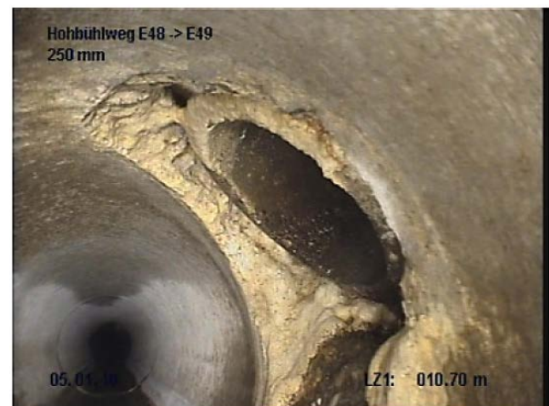
Schadhafter Anschluss vor der Sanierung
