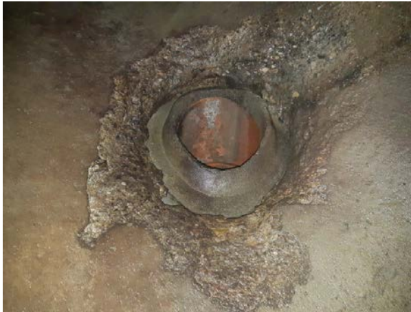
Schadhafter Anschluss vor der Sanierung
