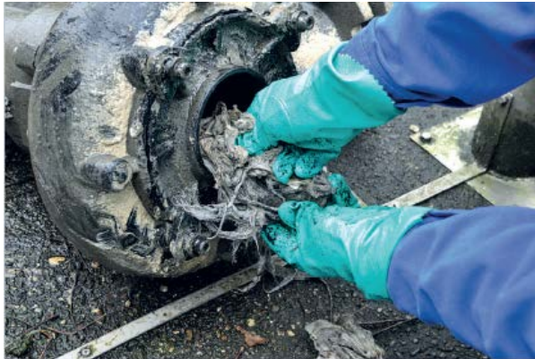
Verstopfte Pumpe – Entfernung und Reinigung von Hand
