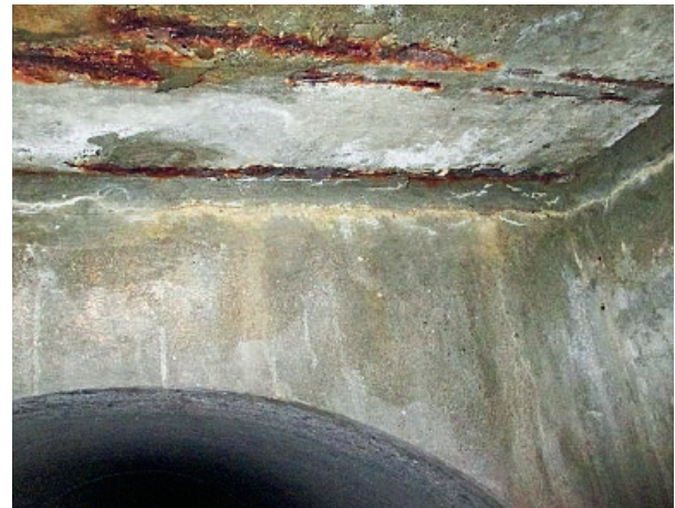
Mängel in Schachtbauwerk wie Abplatzungen und sichtbare Armierung
