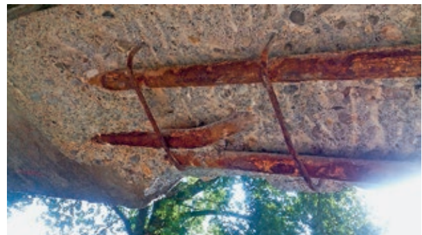
Korrodierte Brückenarmierungen, freigelegt für Behandlung/Sanierung (Sicht von unten)
