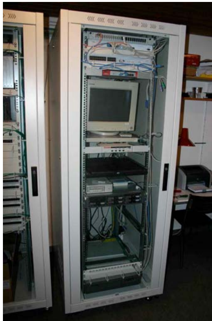
Racks und Server Bünzmatt II
