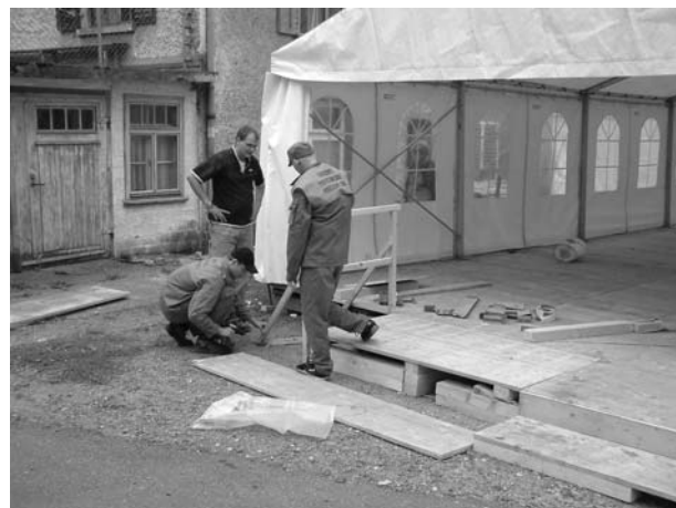
Aufbau der HAGEWO
